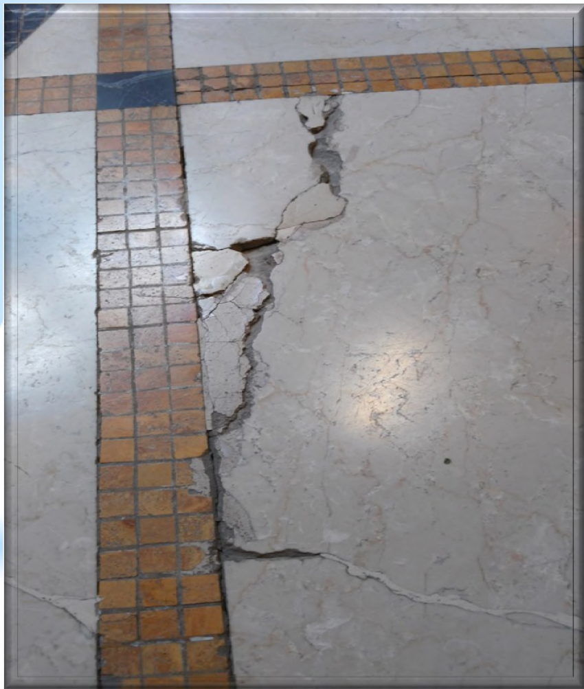
Трещина до ремонта
