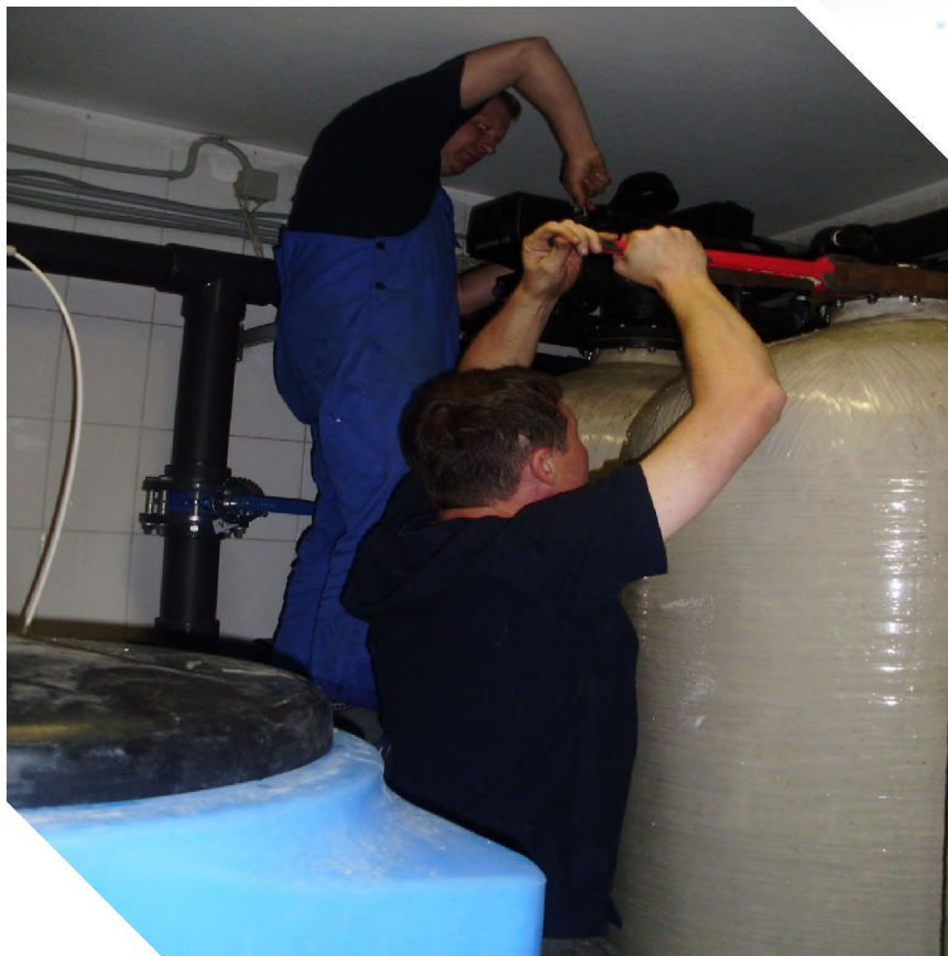
отключение танка от системы водоподготовки для его очистки
