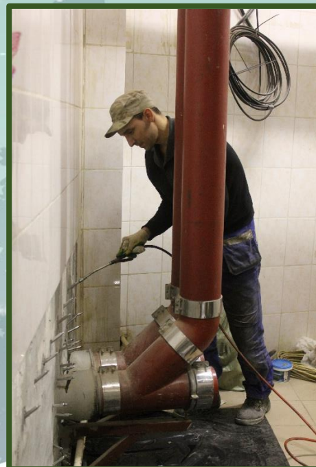
Вскрыт участок стены с протечкой
